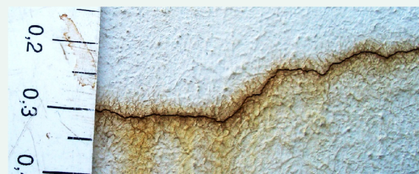
Riss mit Rostfahne am Fundament einer Windkraftanlage
